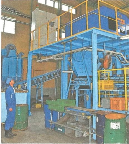
平林金属が西大寺工場に導入した非鉄金属選別の新設備
