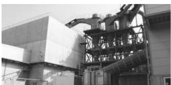
左のコンクリートで覆われた建物が本体・シュレッダー格納庫。中央が集塵・ダスト塔。右側が建物が磁選・非鉄選別ライン棟。
